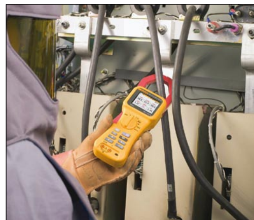
Uppmätning av ström i fasledare
