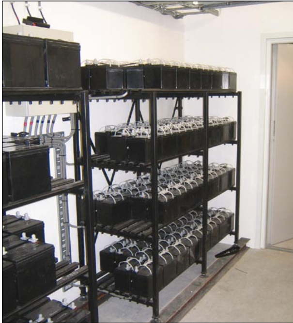
Batterier på ställning
